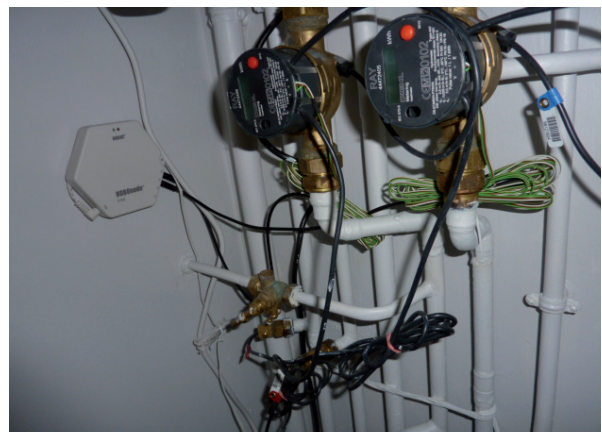
Illustration 2 > Compteur de calories pour le chauffage
